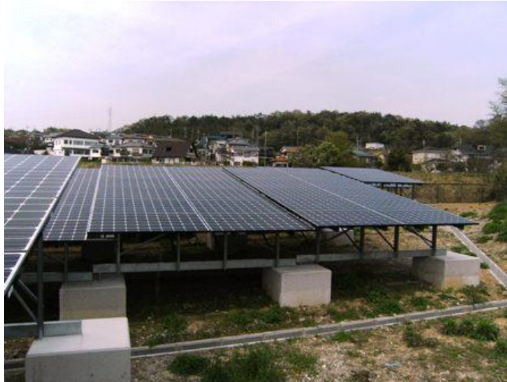
神鉄栄太陽光発電所
